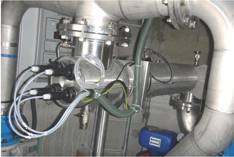
Bild 2: UV-Anlage im Brunnen Dobersdorf
